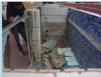
池內設備損壞，池壁斑駁。
